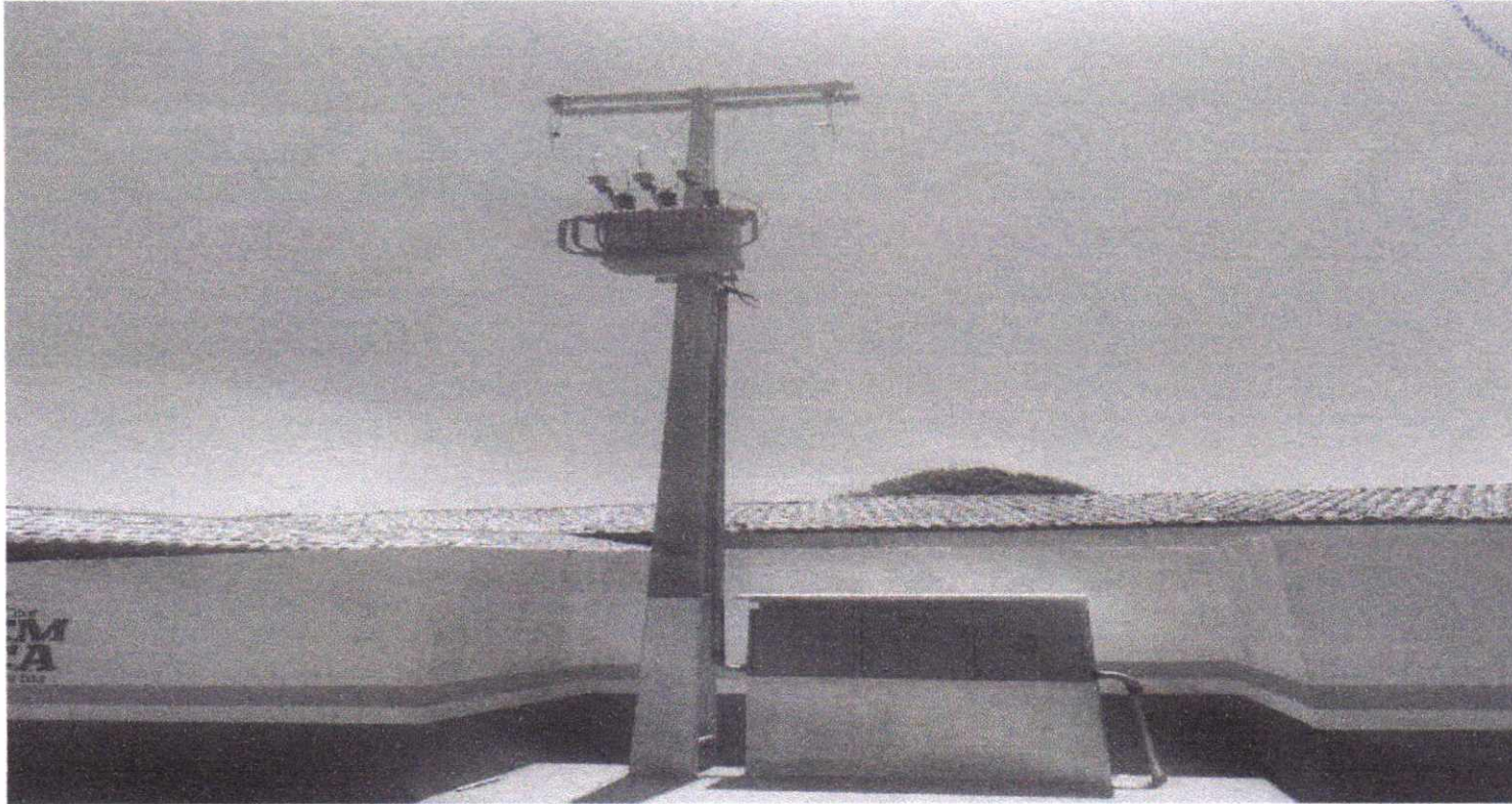
Transformador Hospital Passagem Franca
